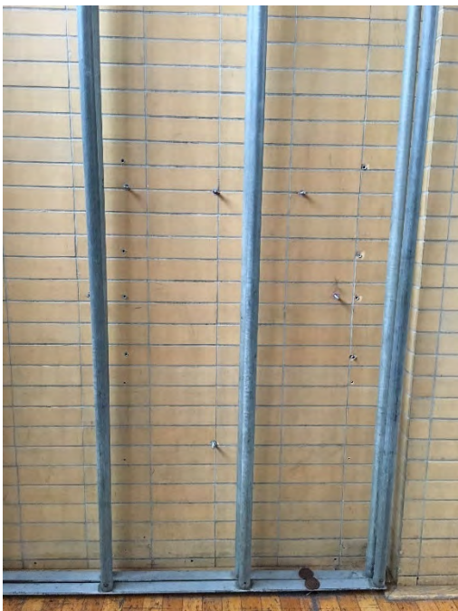
Abb. rechts oben: Hallenraum mit Blick Richtung Bühne Abb. rechts Mitte: beschädigte Hallendecke (Akustikdämmung) Abb. rechts unten: Zustand Hallenboden Abb. links unten: Sporteinbauten Abb. links oben: Gesamteindruck Geräteraumtore
